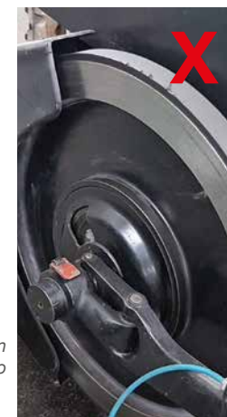
Voorbeeld van een verkeerde beschermkap
