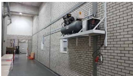
Voorbeeld van een compressor die van de productieruimte verplaatst is naar een zijgang
